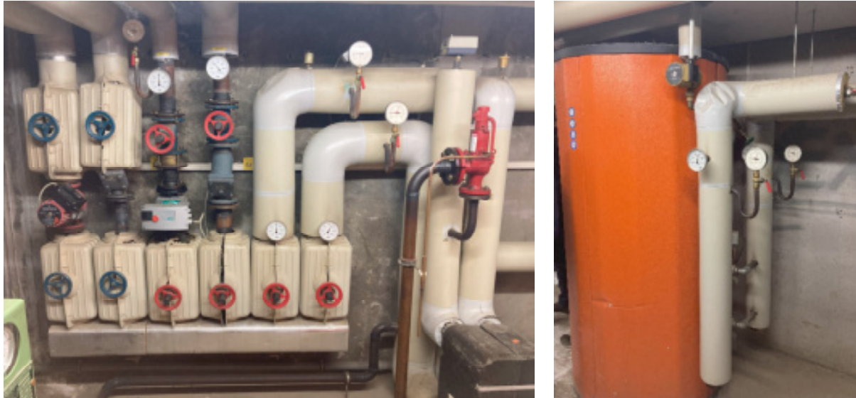
Abb. 15: Wärmeübergabestation und Trinkwarmwasser-Pufferspeicher der Geschosswohnungsbauten
