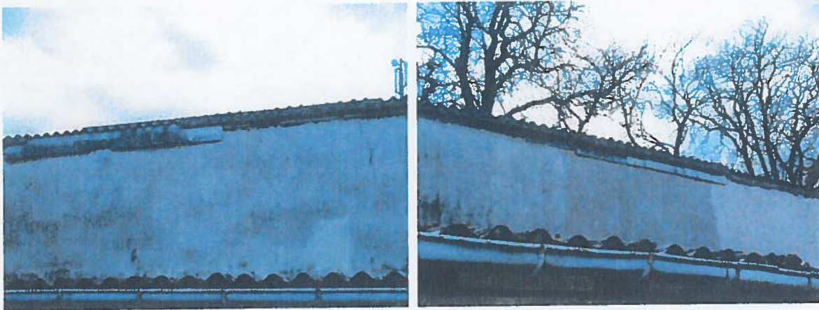
Abb. 4 und 5 Potentielle Fledermaus-Spaltenquartiere unter Asbestplatten an der Dachkante.
